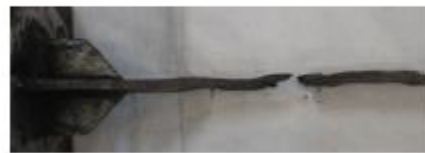
پ) نمای از کنار قسمت گسیخته شده
