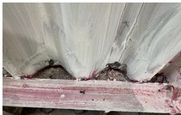
شکل ۱۵- ترک در جوش ورق موج‌دار با ورق اتصال پایین در جابجایی ۰/۴۵٪
