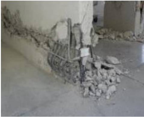
شکل ۱- خردشدگی بتن و کمانش آرماتورهای این ناحیه [۱]
