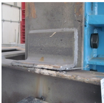
شکل (۱۶): تصاویری از شکستهای مشاهده شده
