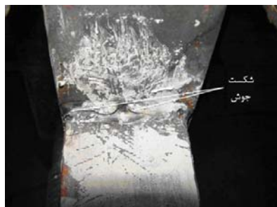
ب- ایجاد مفصل پلاستیک همراه با گسیختگی جوش اتصال
