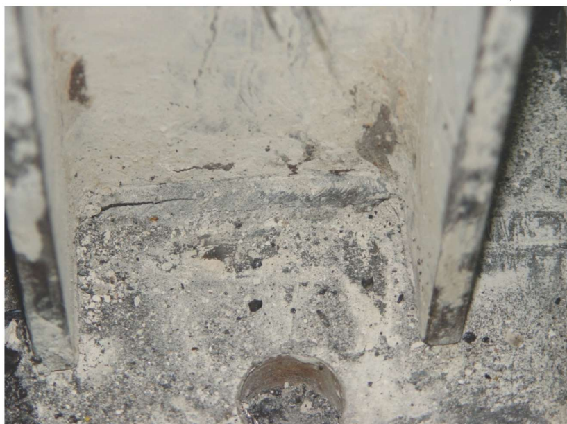
شکل (۹): نمایی از ترک خوردگی در پای ستون بعد از آزمایش
