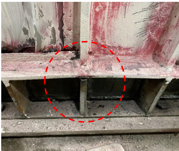
شکل ۱۶- ترک جوش در چشمه اتصال و جوش سخت‌کننده ستون در جابجایی ۰/۲۱۸٪
