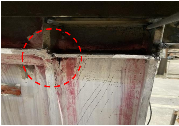
شکل ۱۵- ترک در جوش ورق موج‌دار با ورق اتصال پایین در جابجایی ۰/۴۵٪
