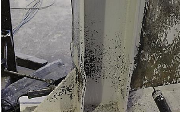
شکل ۱۲- تسلیم بال ستون در مجاورت لبه فوقانی ورق مثلی تقویت اتصال در جابجایی ۲/۸۳٪
