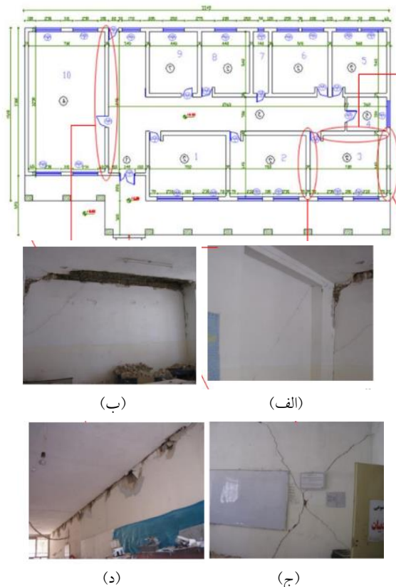
شکل ۲- خرابی‌های یک مدرسه آجری حین زلزله سال ۱۳۹۶ کرمانشاه: (الف) خرابی ناحیه اتصال دیوارهای متعامد، (ب) ریزش دهانه آخر سقف طاق ضربی، (ج) ترک قطری دیوار باربر، (د) لغزش سقف روی دیوار [۳]
