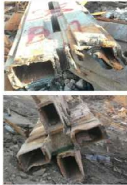
شکل ۱- تخریب ستون‌های ساختمان پلاسکو در درجه حرارت‌های بالا در هنگام حریق
